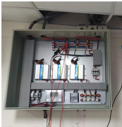
FIGURA 21. TABLERO DEE GENERACIÓN Y CONTROL. Fuente. Autor
