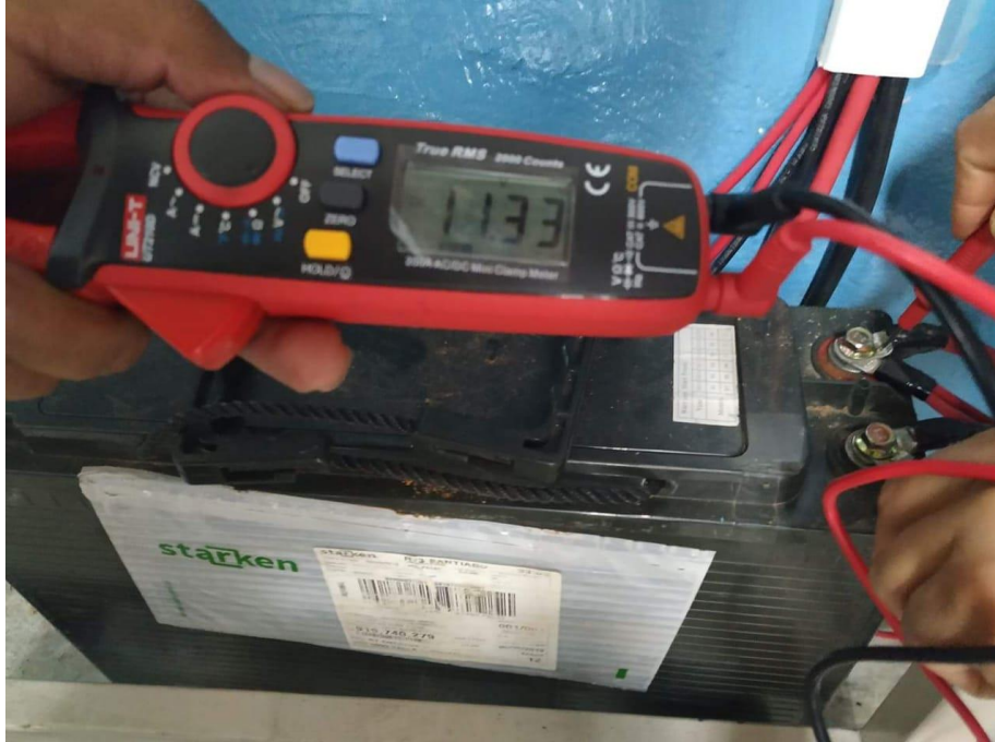
FIGURA 33. SISTEMA DE ALMACENAMIENTO (BATERÍA) Fuente: Autor
