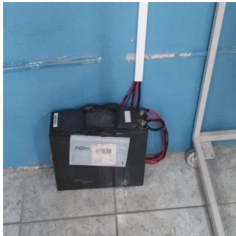
FIGURA 24. INSTALACIÓN DEL SISTEMA DE ALMACENAMIENTO (BATERIA).. Fuente: Autor
