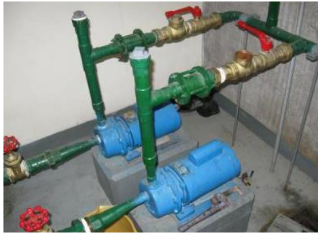
Figura 5. Equipo de bombeo de agua Fuente. (Quindiaguas, s.f.)
