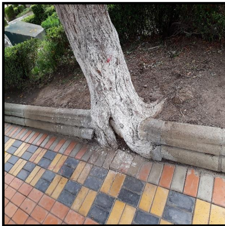
Ilustración 6. Afectación a la infraestructura, parque La Libertad (El Ángel).
