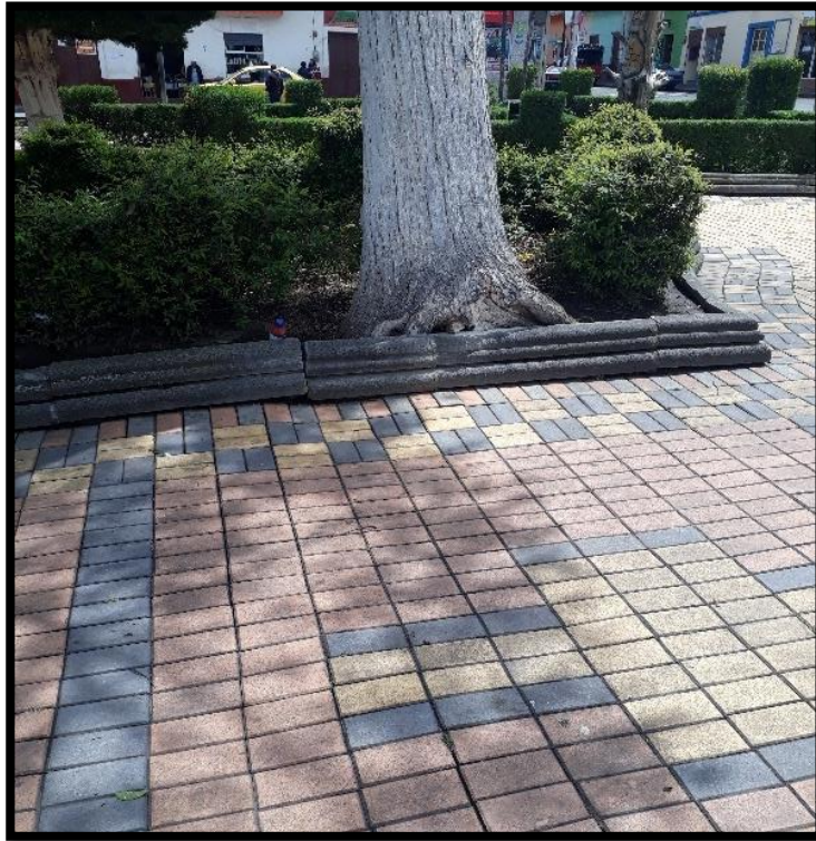
Ilustración 5. Afectación a la infraestructura, parque La Libertad (El Ángel).
