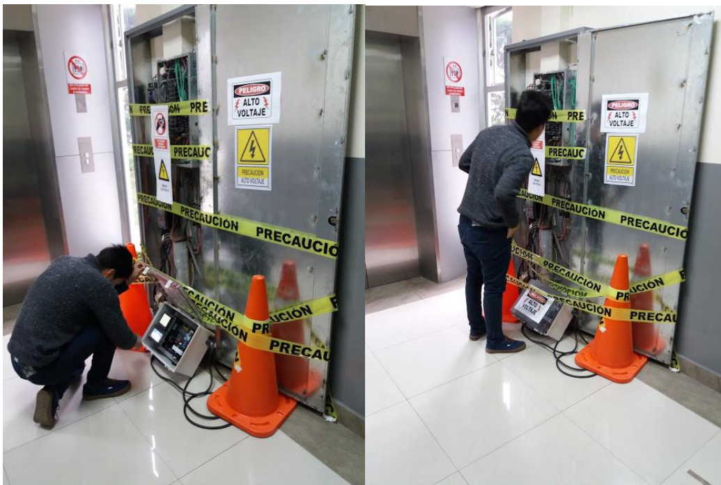
Anexo 2. Instalación del analizador de red en la segunda medición
