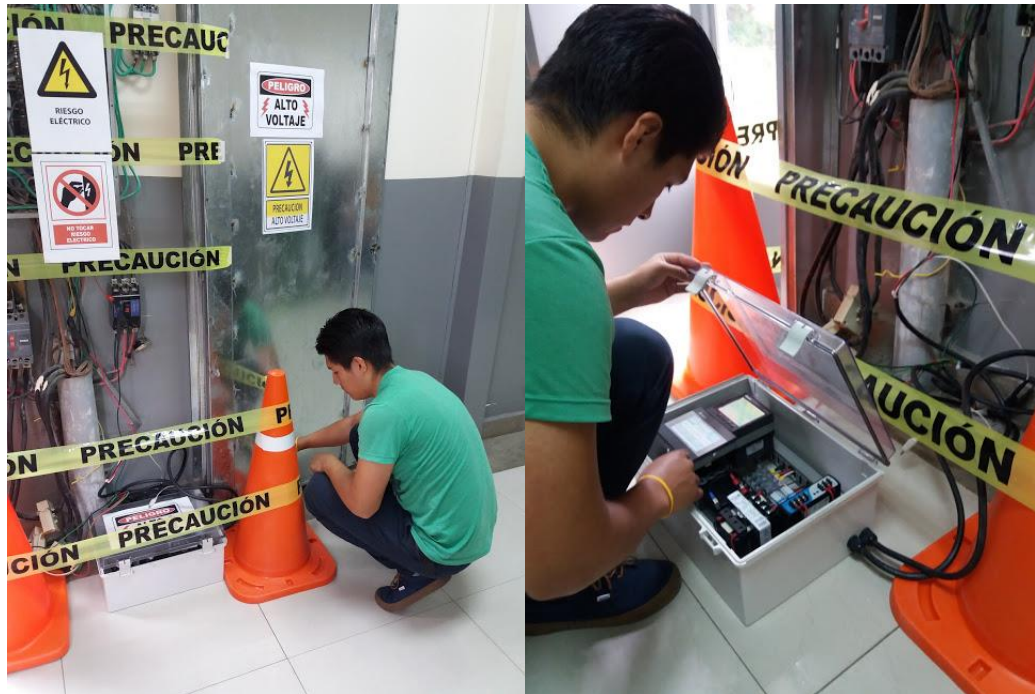
Anexo 1. Instalación del analizador de red en la primera medición
