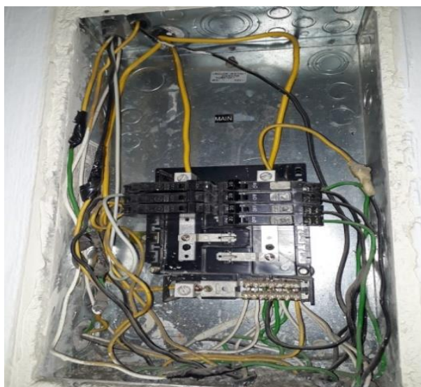
Fig. 2.11: Panel de distribución 5.
