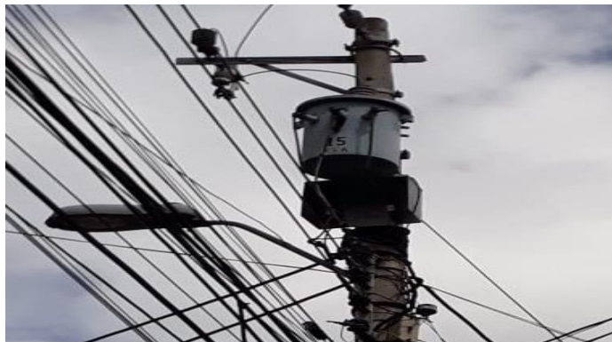
Fig. 2.2: Transformador monofásico de 15 kVA.
