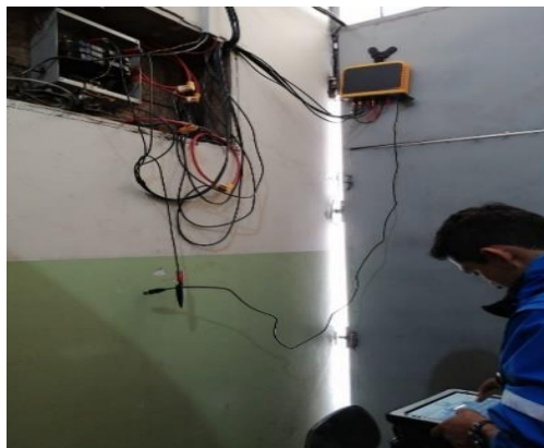
Fig. 2.14: Instalación del instrumento de medida.
