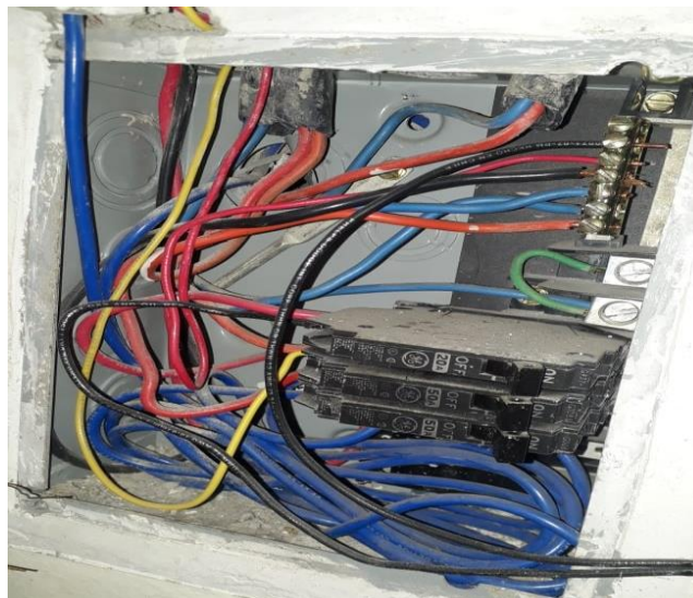
Fig. 2.9: Panel de distribución 3.
