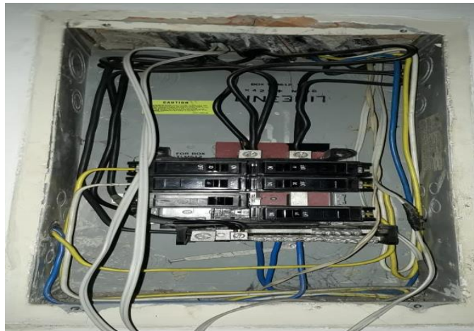
Fig. 2.7: Panel de distribución 1.
