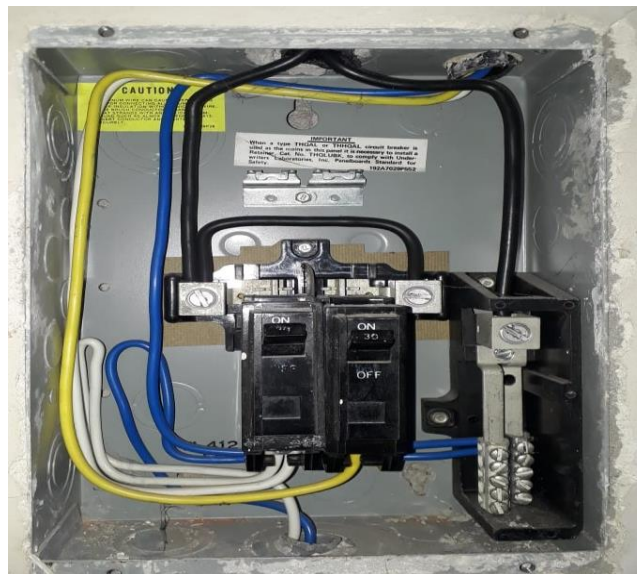
Fig. 2.8: Panel de distribución 2.
