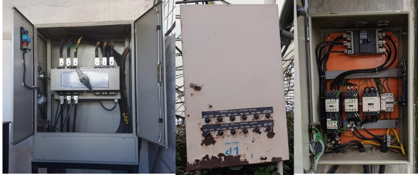
Ilustración 10: ejemplos de cuadros eléctricos presentes en la florícola Elaborado por: Luis Chacón Fuente: Propia
