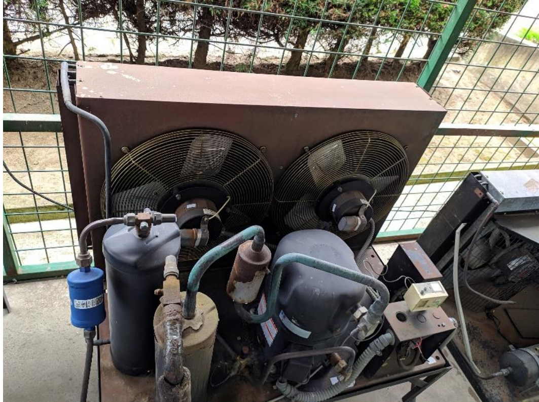
Ilustración 13: Equipo de aire acondicionado cuartos fríos Elaborado por: Luis Chacón Fuente: Propia
