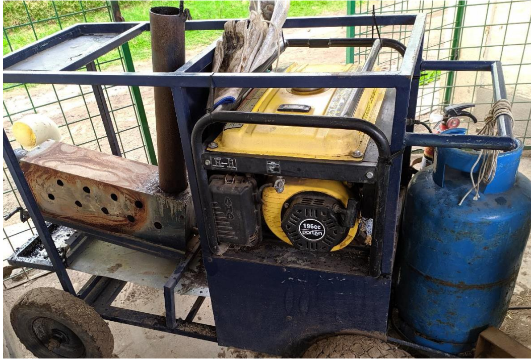
Ilustración 12: Generador de servicio secundario Elaborado por: Luis Chacón Fuente: Propia
