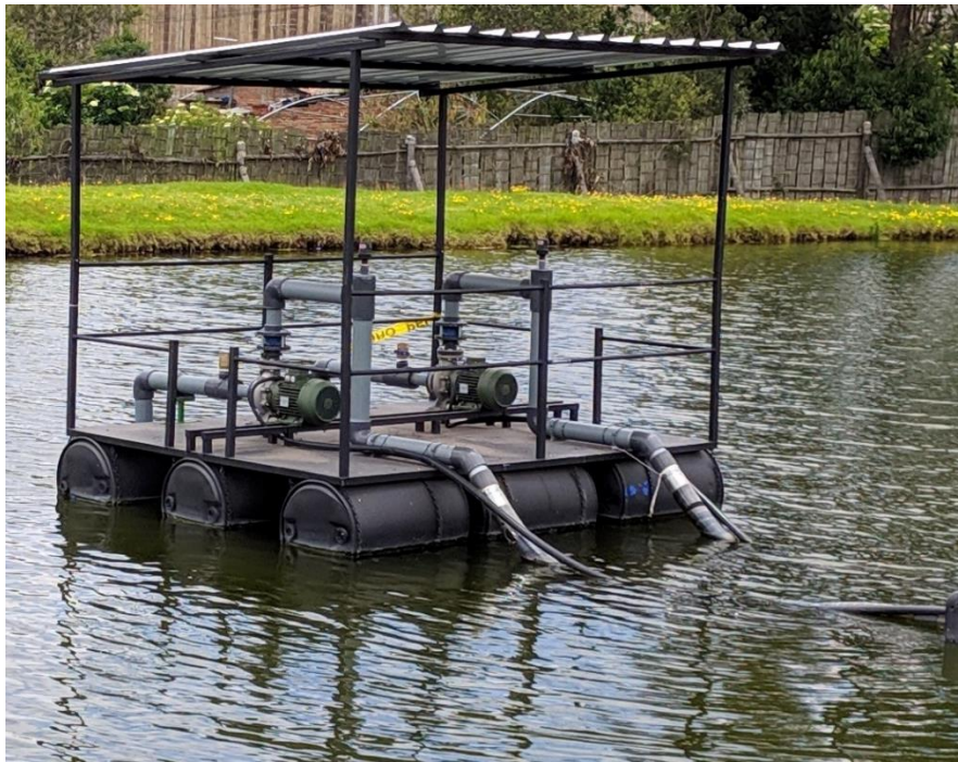
Ilustración 14: Balza de bombeo alimentación reservorio Elaborado por: Luis Chacón Fuente: Propia
