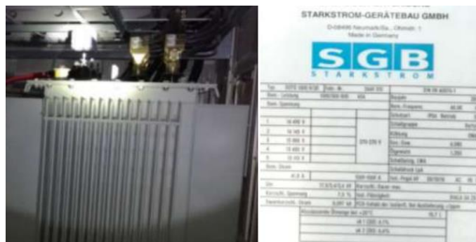
Fig. 11: Transformador en sitio "Parque solar Salinas" y placa de características respectivas Fuente: Elaborado por el Autor
