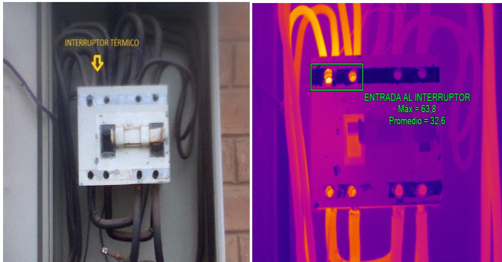
Fig. 2. 9 Imagen termográfica del interruptor térmico del tablero principal del transformador #1
