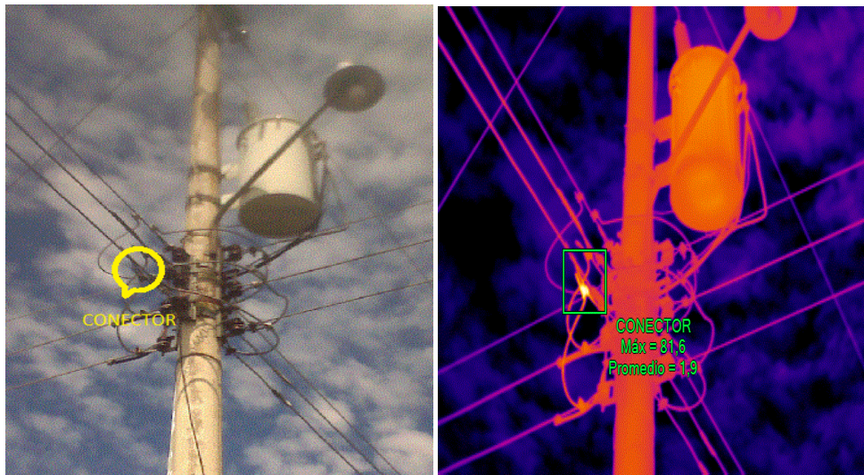
Fig. 2. 8 Imagen termográfica de las líneas de bajo voltaje
