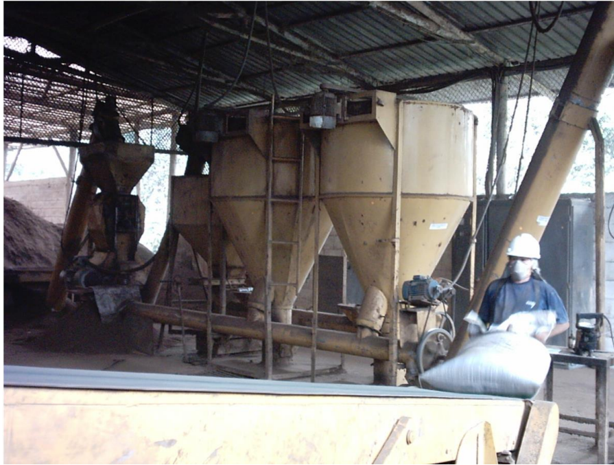
Figura 44 Tolvas PRONACA – Planta de Santo Domingo de los Tsáchilas [38]
