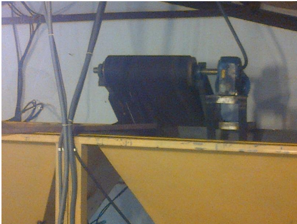
Figura 19 Banda de alimentación para tolvas
