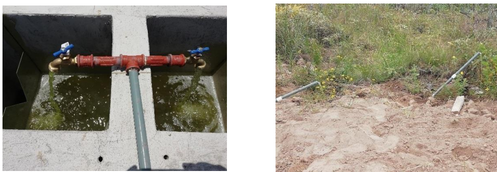
Figura 6. Fosas de Recepción de aguas residuales y Tubos de descarga
