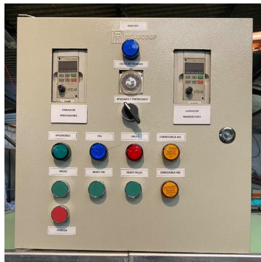
Anexo 13. A. Tablero de control.
