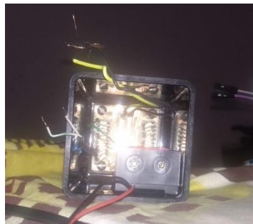
Figura 57: Disposición interna de los módulos inalámbricos.
