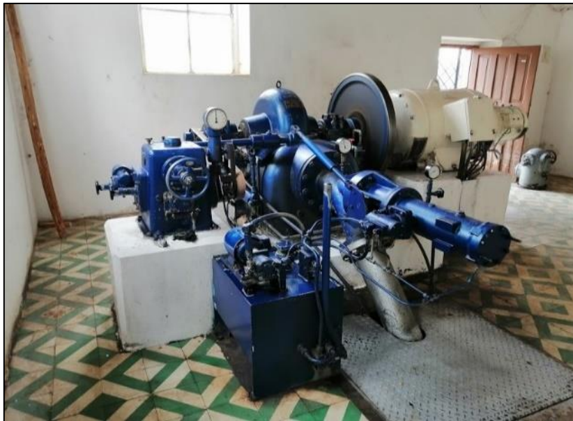
Fig. 2.3: Unidad de generación #2 Fuente: Delgado Pabón & Morales Rosero, 2020.
