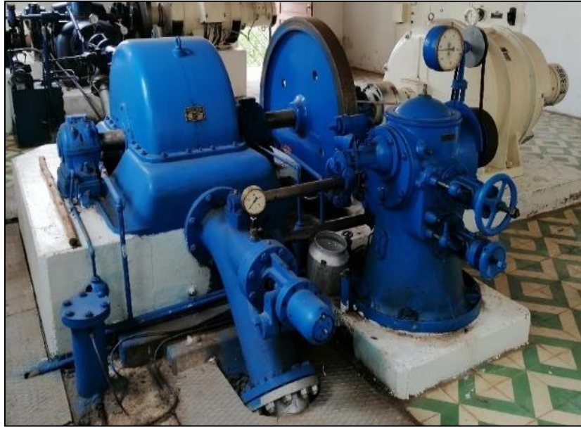
Fig. 2.2: Unidad de generación #1 Fuente: Delgado Pabón & Morales Rosero, 2020.
