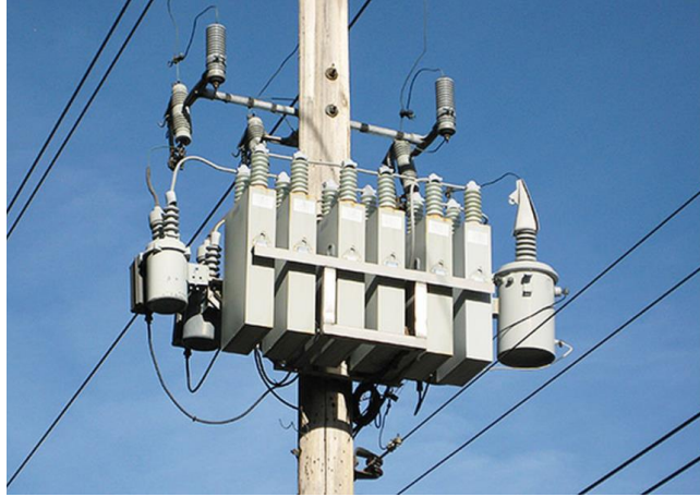
Figura 5. Banco de condensadores en red de media tensión
