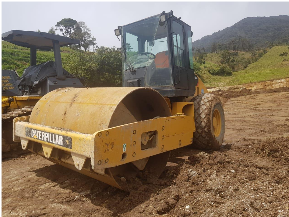
Figura A.I.1 Verificación del estado actual de la unidad ECR-001
