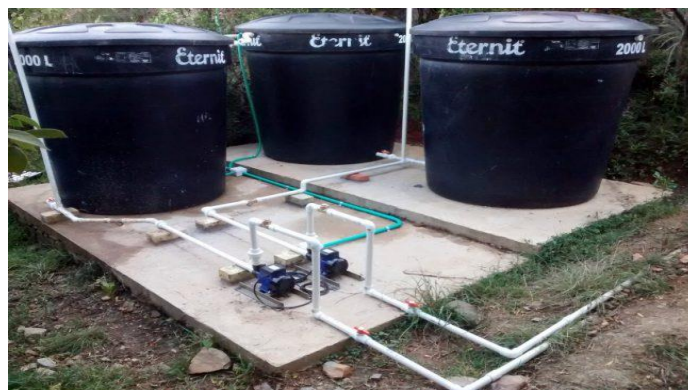
Figura 14. Tanques de almacenamiento de agua
