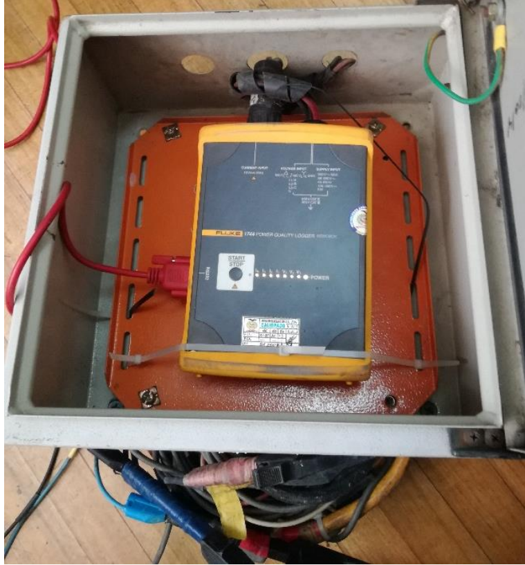
Fig. 14. Fluke 1744 Power Quality Logger Fuente: Propia
