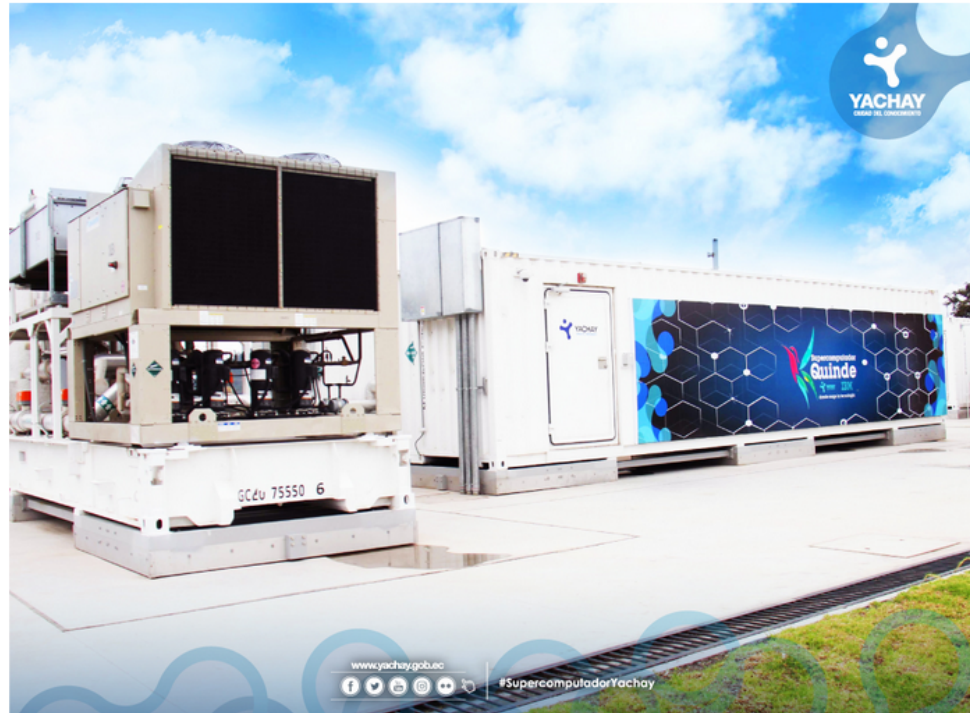
Figura 2. Fotografía del Data Center de la Empresa Pública Siembra E.P., donde se encuentra alojado el Supercomputador Quinde I.
