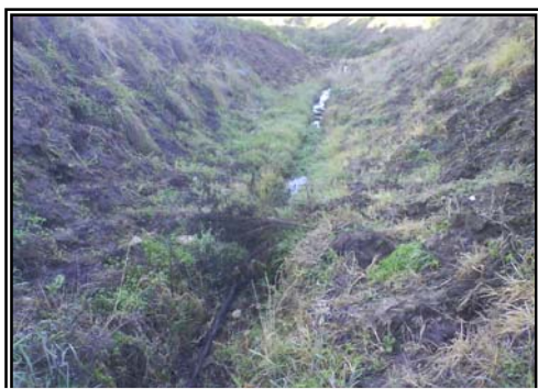
Descarga que proviene del sector del Colegio y Hospital Hospital y Colegio
