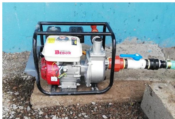
Figura 23 Ubicación Fija de la Motobomba
