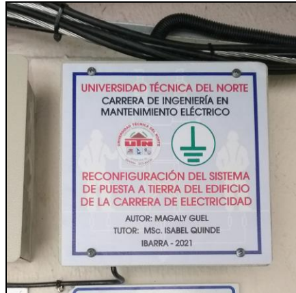
Fig. 62. Caja de conexión de tierra con su tapa de protección Fuente: (Autor, 2021)
