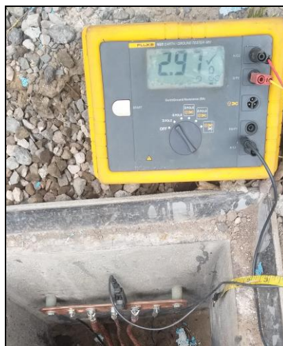
Fig. 69. Conexión del equipo de medición con el sistema de puesta a tierra reconfigurado. Fuente: (Autor, 2021)
