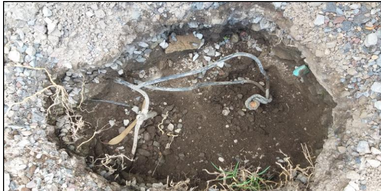
Fig. 19. Conexión de la puesta a tierra de la bobina de tesla y la malla principal. Fuente: (Autor, 2021)
