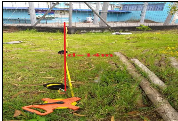
Fig. 25. Ubicación para la medición de la resistencia de puesta a tierra del sistema Smart Grid. Fuente: (Autor, 2021)
