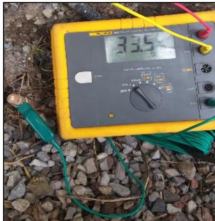
Fig. 31. Conexión del equipo de medición con la tierra del sistema de generación fotovoltaica y solar. Fuente: (Autor, 2021)
