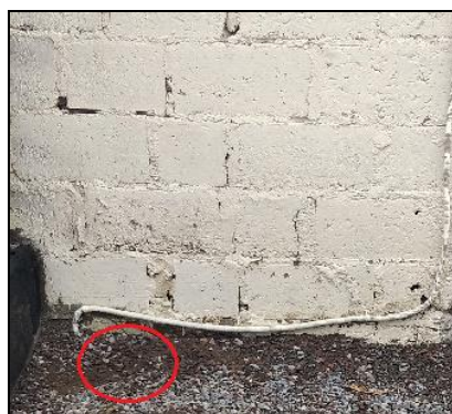
Fig. 28. Puesta a tierra del sistema fotovoltaico Fuente: (Autor, 2021)
