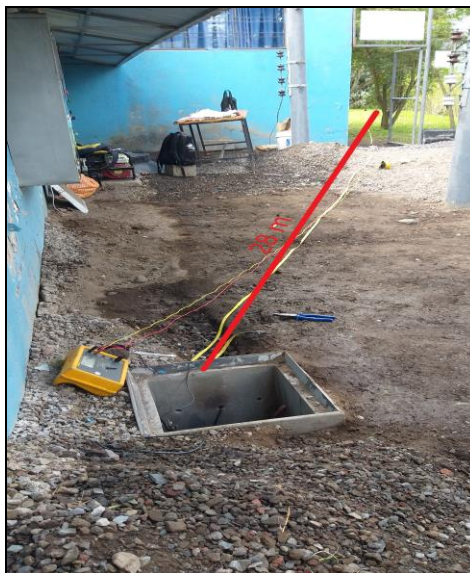
Fig. 66. Ubicación para la medición de la resistencia de puesta a tierra de la malla. Fuente: (Autor, 2021)
