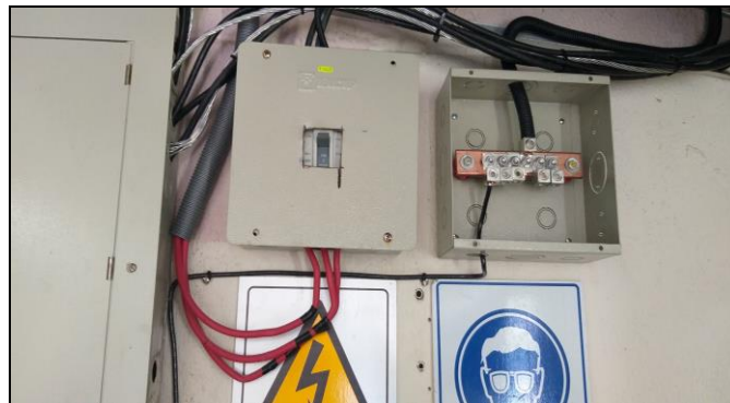
Fig. 61. Conexión de la puesta a tierra reconfigurada en la caja de conexión de tierras. Fuente: (Autor, 2021)
