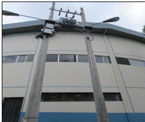
Fig. 33. Transformador trifásico de 75 kVA junto al Auditorio Agustín Cueva Fuente: (Autor, 2021)
