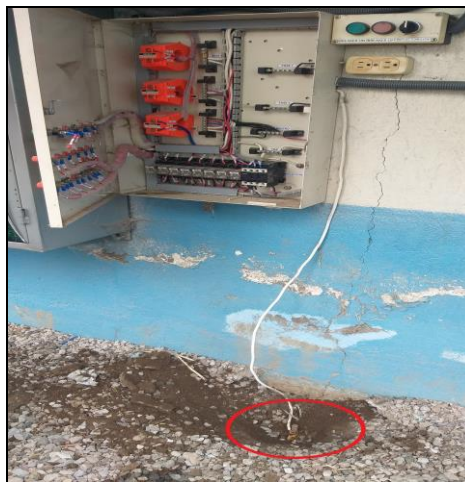
Fig. 23. Módulo de control y fuerza. Fuente: (Autor, 2021)
