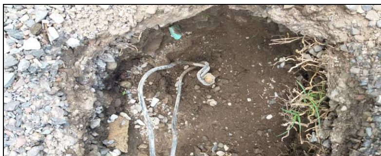
Fig. 18. Pozo del electrodo de puesta a tierra de la bobina de tesla. Fuente: (Autor, 2021)
