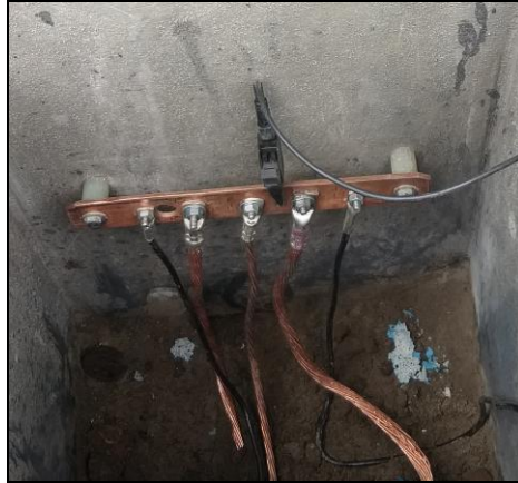
Fig. 59. Conexión de los terminales de los conductores a la barra de tierra Fuente: (Autor, 2021)
