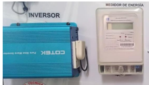
Fig. 44 Montaje del inversor de corriente y medidor de energía Fuente: Autor
