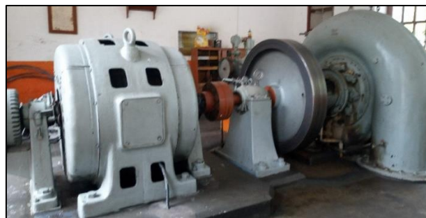
Fig. 25 Generador unidad 1 Fuente: Propia del autor, 2021
