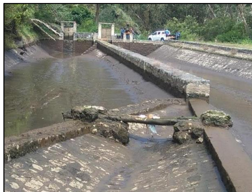
Fig. 20 Tanque de sedimentación
