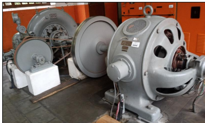
Fig. 27 Generador unidad 3 Fuente: Propia del autor, 2021
