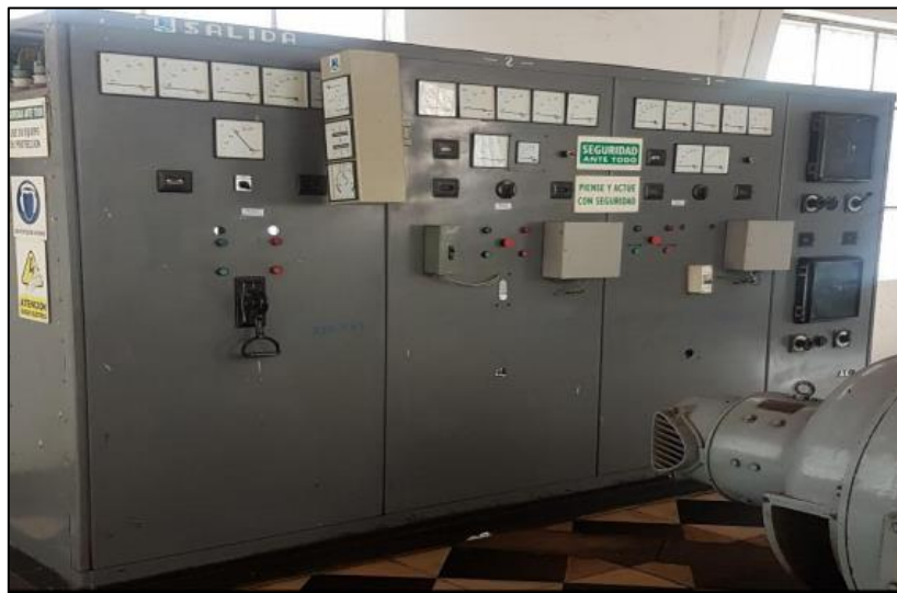
Fig. 13 Tablero de control Fuente: Propia del autor, 2021
