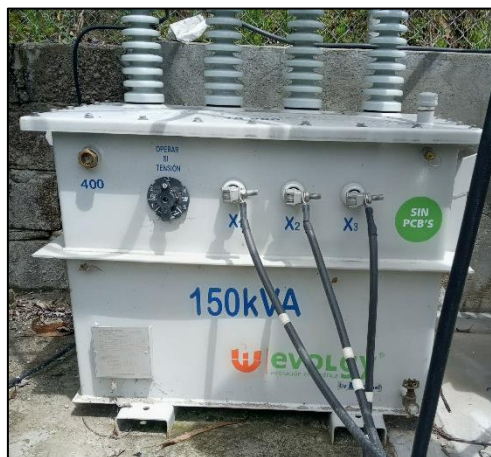
Fig. 31 Transformador de potencia unidad de generación 2 Fuente: Propia de autor, 2021
