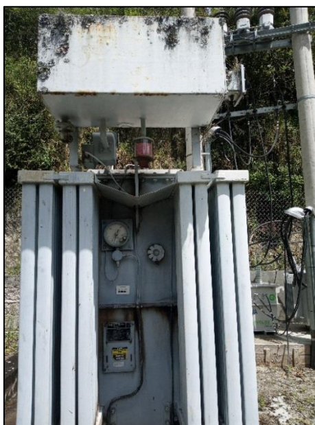
Fig. 30 Transformador de potencia unidad de generación 1 Fuente: Propia de autor, 2021
