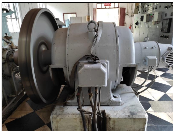
Fig. 12 Unidad de generación y excitatriz Fuente: Propia del autor, 2021
