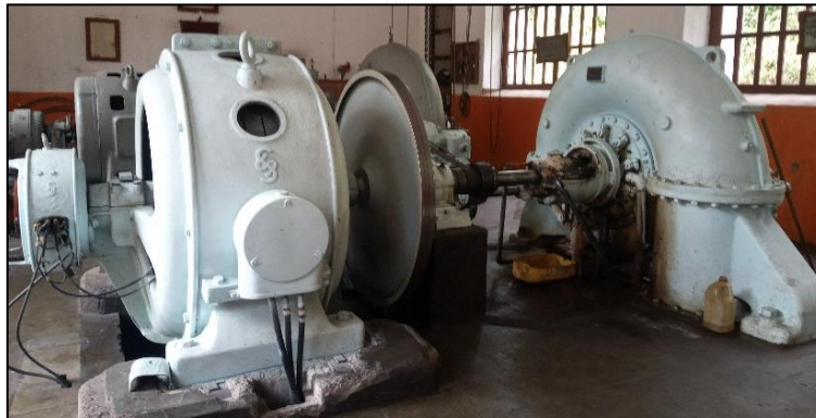
Fig. 26 Generador unidad 2 Fuente: Propia del autor, 2021
