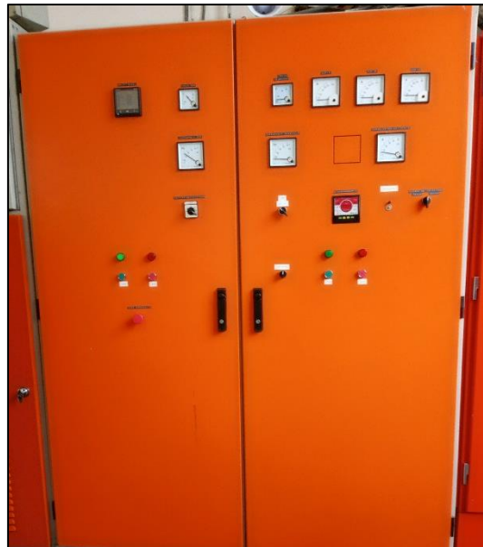
Fig. 29 Datos de placa tablero de control 3 Fuente: Propia de autor, 2021
