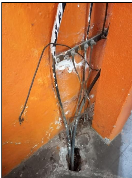
Fig. 34 Barra de tierra Fuente: Propia de autor, 2021
