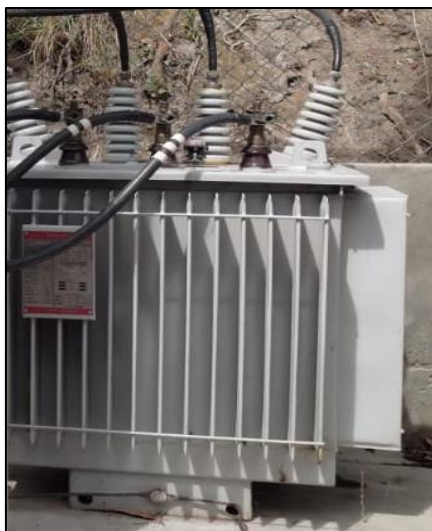
Fig. 32 Transformador de potencia unidad de generación 3 Fuente: Propia de autor, 2021
