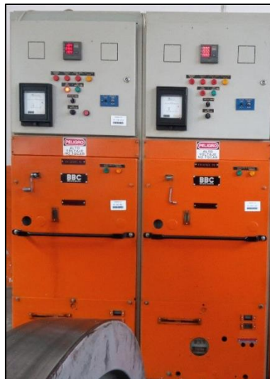
Fig. 28 Tablero de control 1 y 2 Fuente: Propia de autor, 2021
