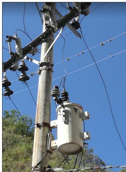
Fig. 15 Transformador de Distribución Fuente: Propia del autor,2021
