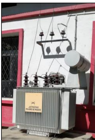
Fig. 14 Transformador de potencia Fuente: Propia del autor,2021
