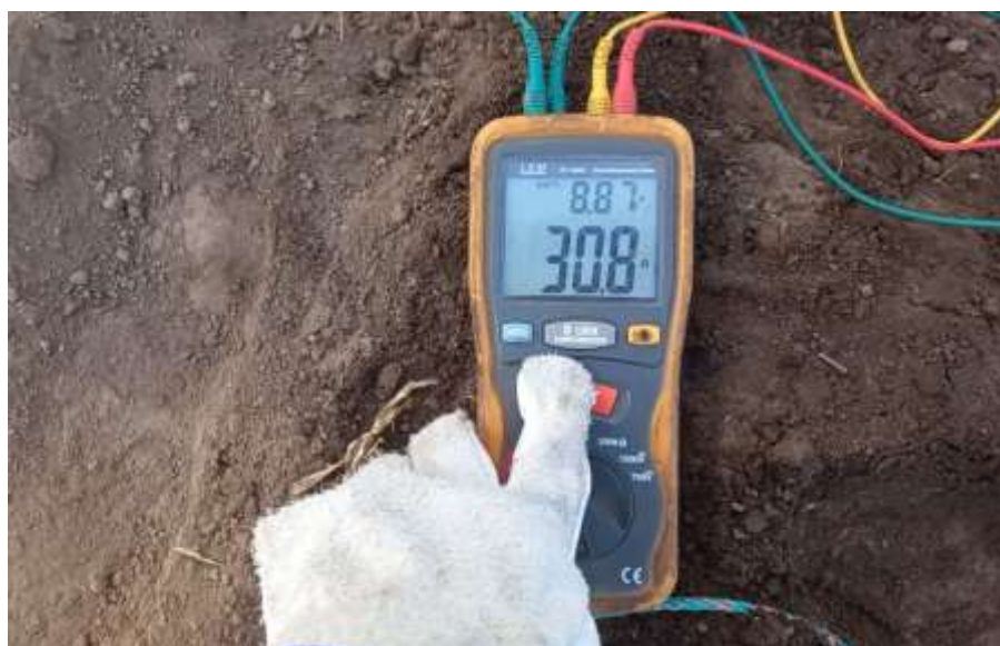
Figura G 37: Resistencia de una varilla instalada
