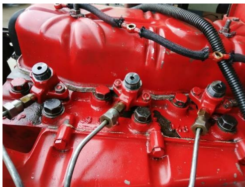
Figura 2.24. Desregulación de tornillo de reglaje, falla 2.
