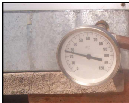
Fotografía N° 3.22. Termómetro de salida
