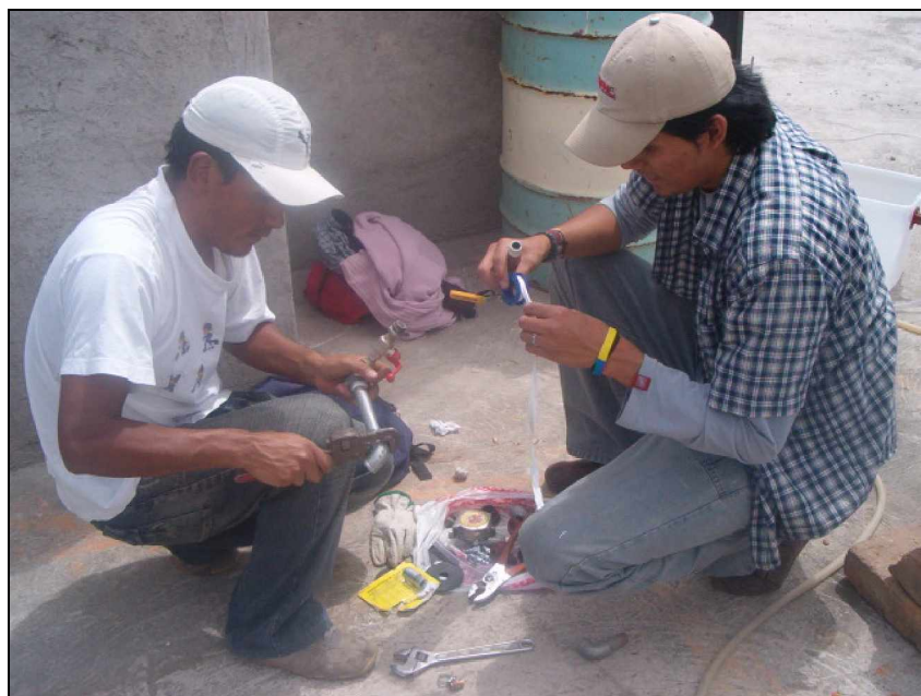
Fotografía N° 4 Conexiones de la red de tuberías
