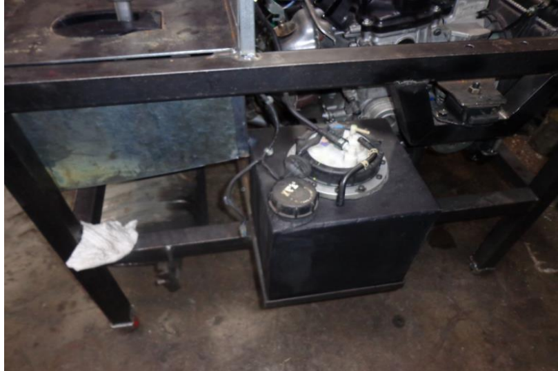
Figura AII. 3 Tanque de combustible
