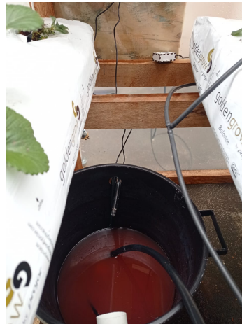
Figura 4.4: Instalación del sensor de pH y Conductividad eléctrica
