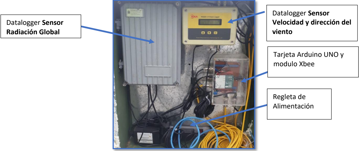
Figura 9. Tablero de Control
