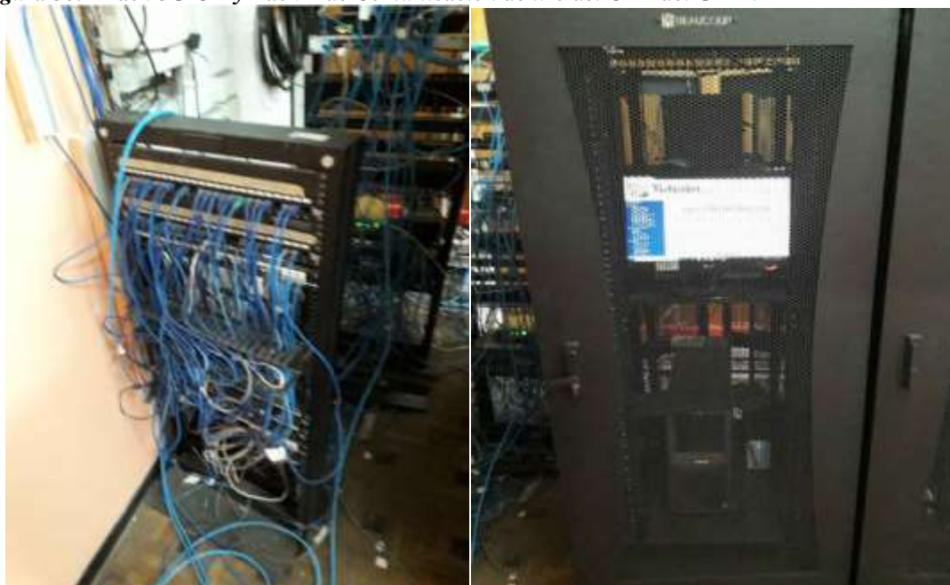
Figura 30. Rack 3G-UR y Rack-2 de Comunicación dentro del CPD del GADMT
