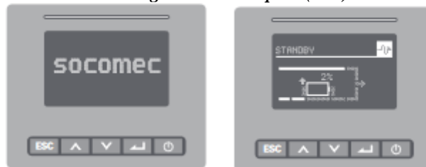
Figura 18. Arranque del Sistema de Energía Ininterrumpida (SAI)
