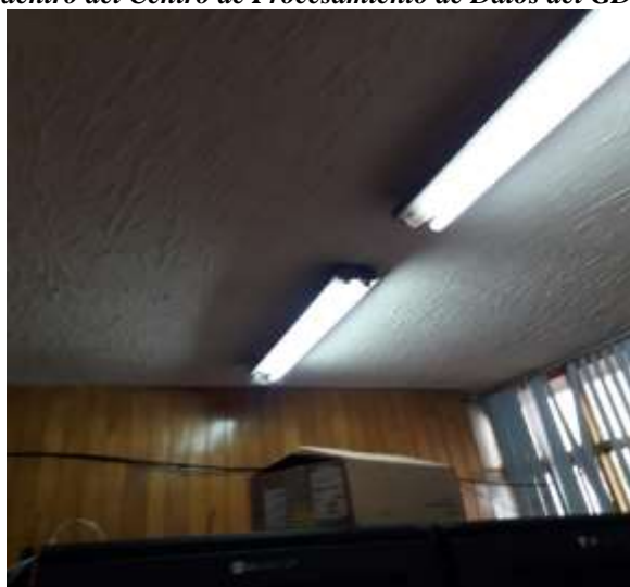
Figura 21. Luminarias dentro del Centro de Procesamiento de Datos del GDMT
