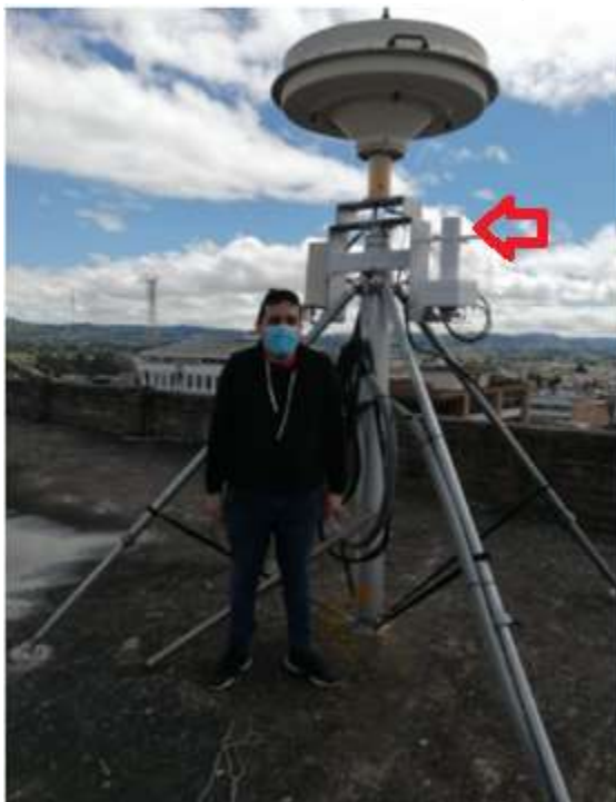
Figura 31. Antena Ubiquiti AirMax LiteBeam ubicada em la Terraza de la Edificación del GADMT
