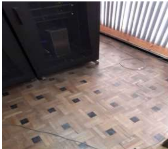
Figura 20. Piso del Cuarto de Telecomunicaciones del GADMT
