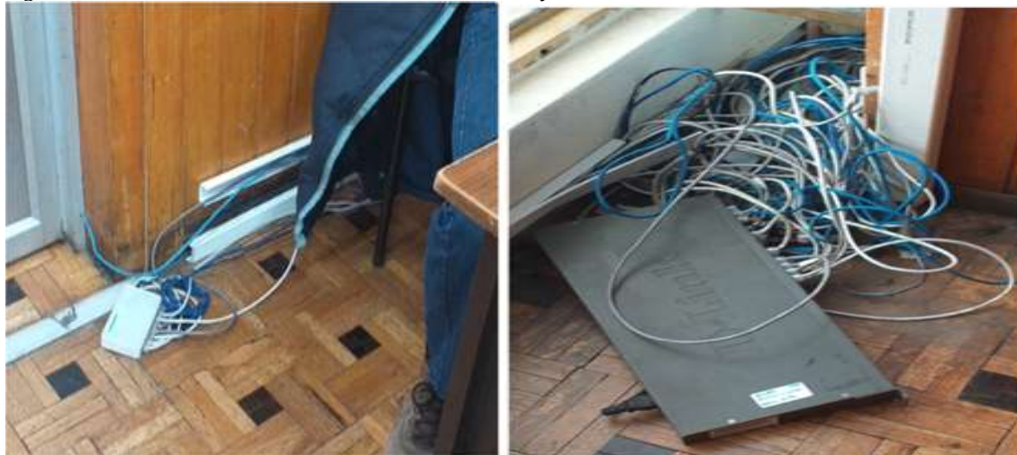
Figura 32. Distribución mal adecuada del Canaletas y Puntos de Red en el GADMT
