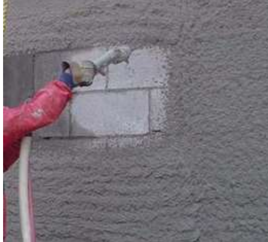
Figura 9. Enlucido de la pared mediante adhesión de cemento generado una capa de 1.5cm a 2cm
