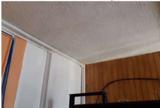
Figura 24. Instalación del Centro de Procesamiento de Datos (Carencia de Sistema de Climatización)
