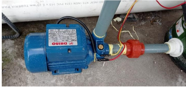
Figura 4.25 Bomba de agua de 110 v
