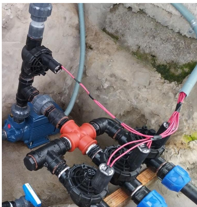
Figura 4. 5 Sistema de electroválvulas instalado
