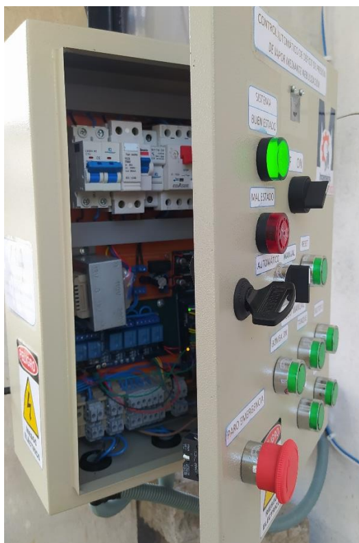
Figura 4. 11 Vista externa del tablero de control
