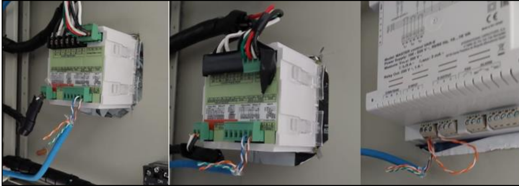
Fig. 5: Conexión de Analizadores de Red. Fuente: El Autor.
