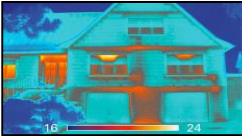
Figura 24. Imagen térmica de un edificio con pérdidas de calor.
