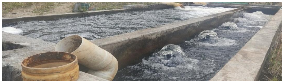
Tanque de captación y filtrado de agua
