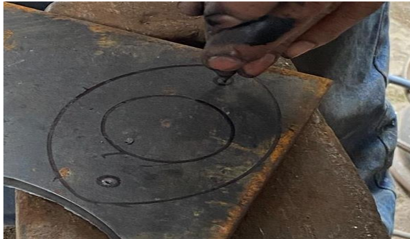
FIGURA 3.14 Señalización de bridas
