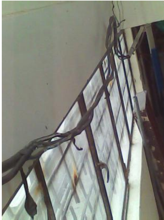
Figura 28. Distribución eléctrica de 110 y 220 v en malas condiciones. (Rivera Pinto & Valdez Perugachi, 2012).
