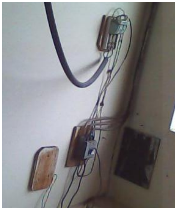
Figura 31. Cables que pasan por diferentes cajas térmicas que dificultan un buen manejo de las mismas. (Rivera Pinto & Valdez Perugachi, 2012).
