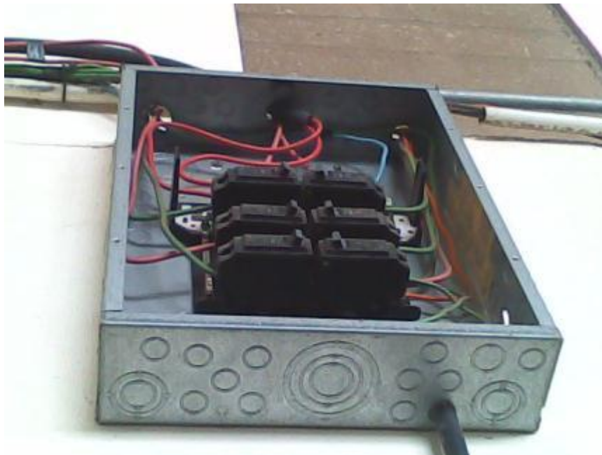
Figura 23. Caja térmica en malas condiciones y con un sinfín de cables. (Rivera Pinto & Valdez Perugachi, 2012)
