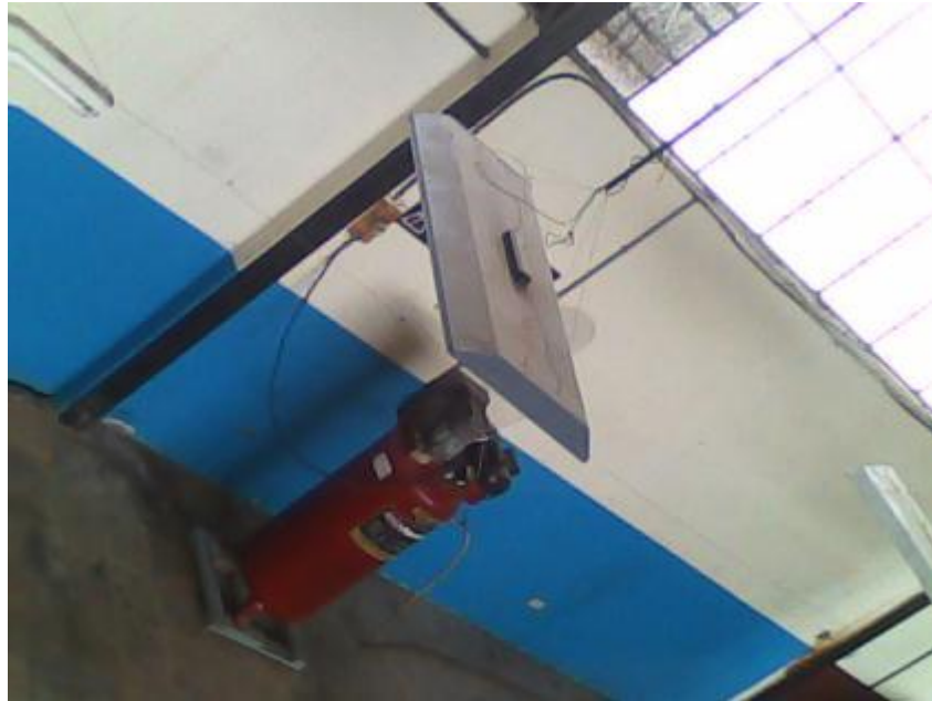
Figura 32. Inadecuada ubicación de luminarias. Altura baja. (Rivera Pinto & Valdez Perugachi, 2012)
