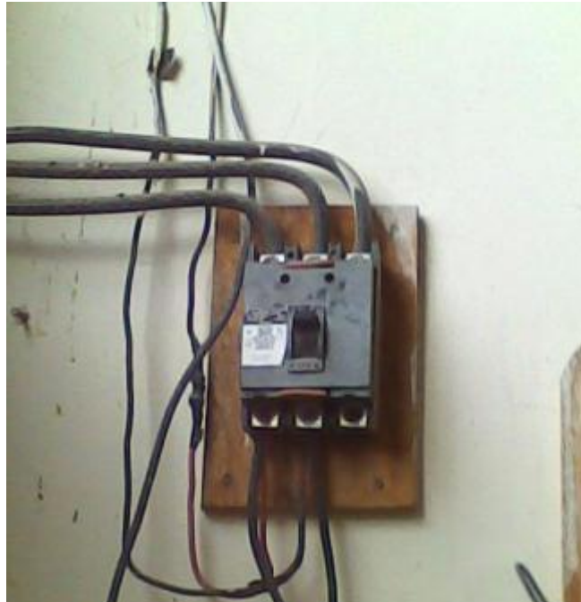
Figura 30. Cables que llegan directamente desde el transformador. (Rivera Pinto & Valdez Perugachi, 2012).
