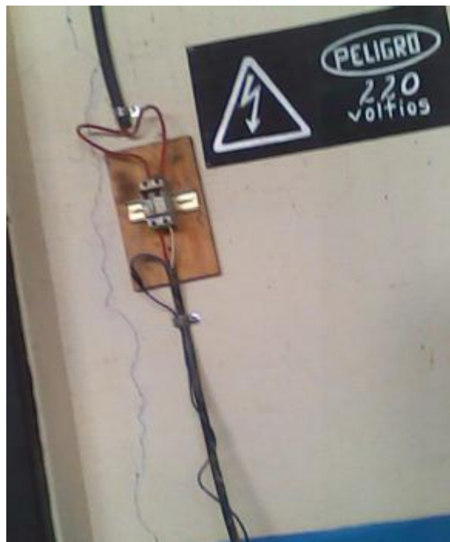
Figura 25. Inadecuada instalación eléctrica en el Tanque compresor. (Rivera Pinto & Valdez Perugachi, 2012)
