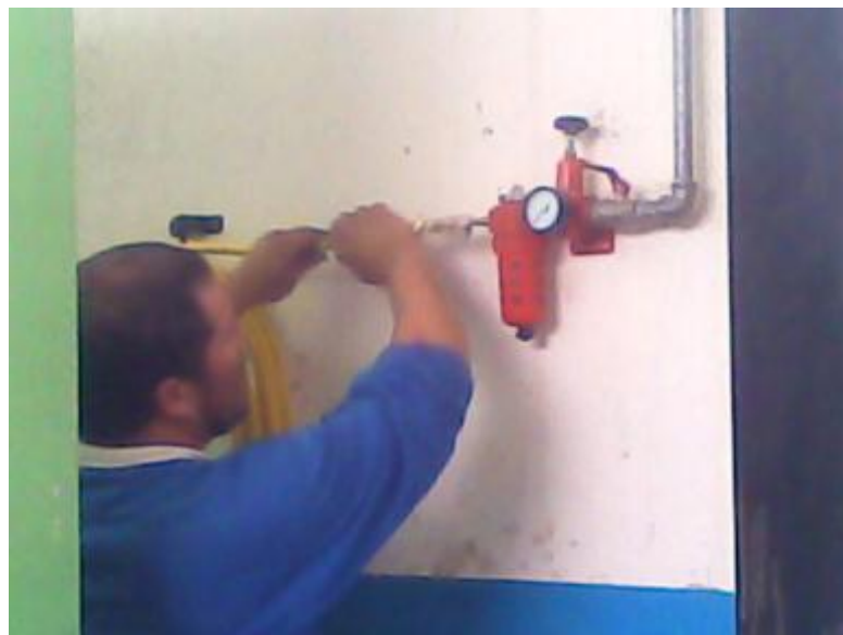
Figura 50. Instalación de accesorios para buen funcionamiento del aire comprimido. (Rivera Pinto & Valdez Perugachi, 2012).
