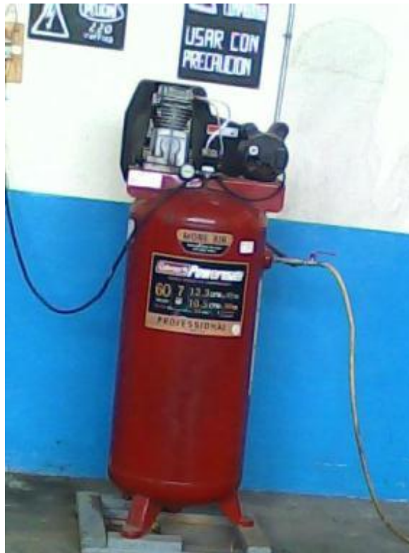
Figura 36. Tanque compresor en buena ubicación pero falta seguridad en su instalación. (Rivera Pinto & Valdez Perugachi, 2012).
