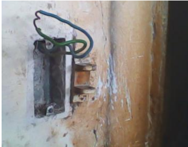
Figura 24. Mala instalación de interruptores. (Rivera Pinto & Valdez Perugachi, 2012).
