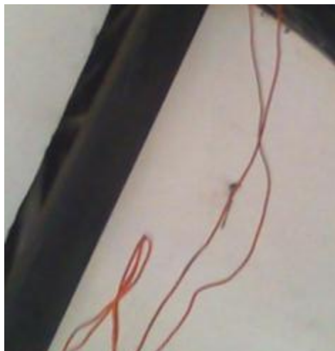
Figura 38. Instalaciones electricas que constituian un peligro. (Rivera Pinto & Valdez Perugachi, 2012).
