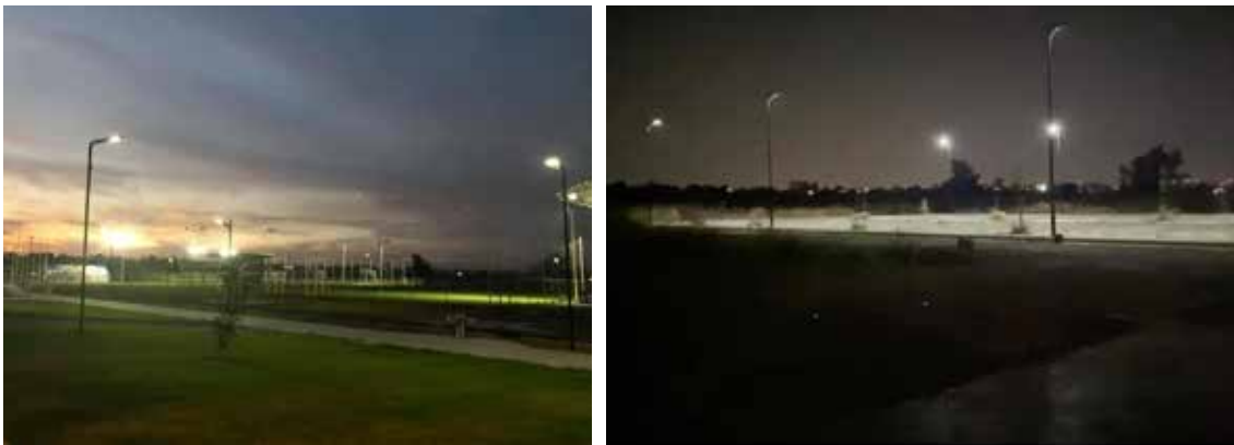
Figura 9. Alumbrado exterior fotovoltaico de canchas, andadores y estacionamiento.
