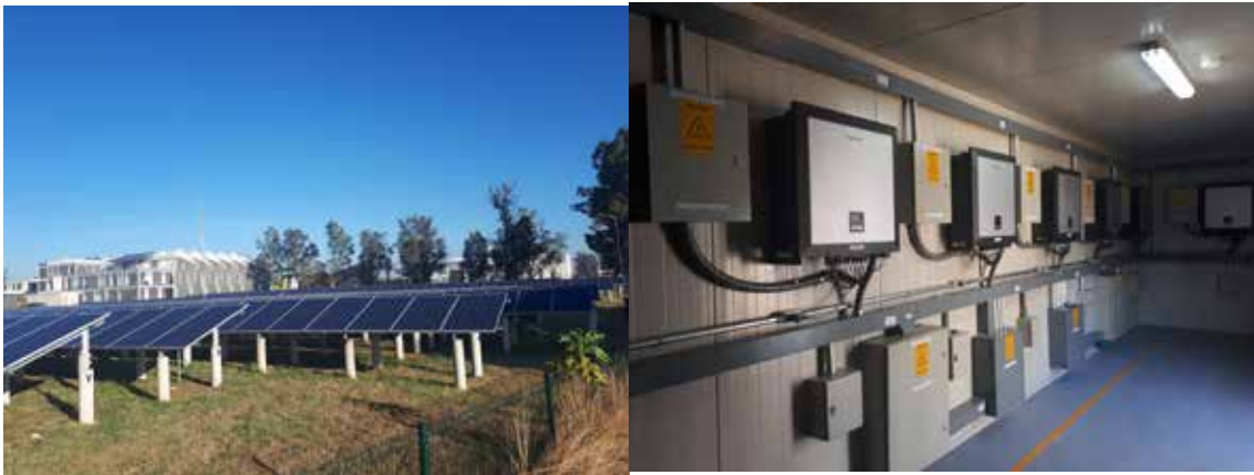
Figura 13. a) Huerto solar fotovoltaico de 499 kWp del Centro Universitario de Tonalá de la Universidad de Guadalajara. b) Cuarto de inversores
