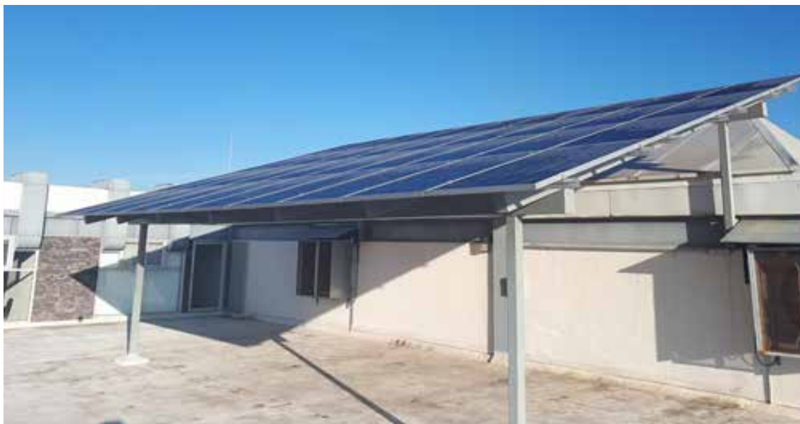
Figura 11. Terraza fotovoltaica del Instituto de Energías Renovables.
