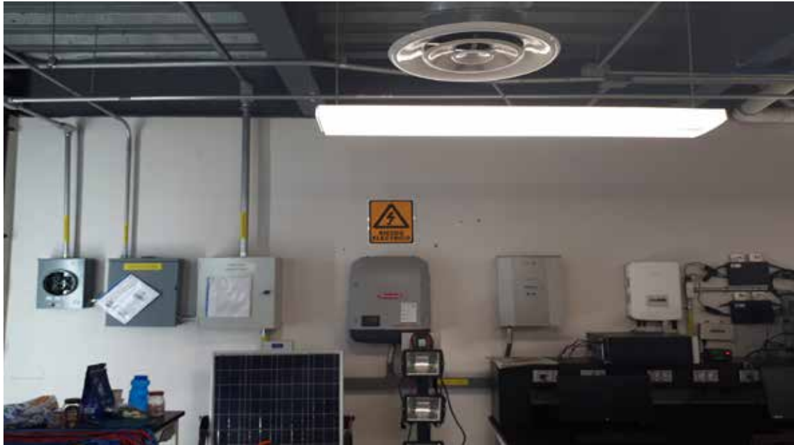
Figura 12. Inversores de la terraza fotovoltaica.
