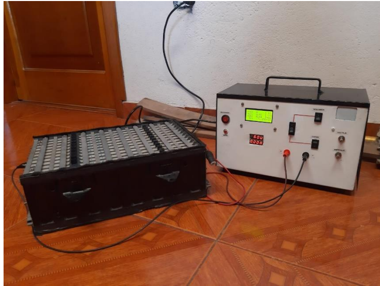
Figura. 6.1 Descarga de las baterías
