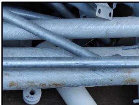
Fig. 1. Corrosión en poste de iluminación de acero galvanizado.
