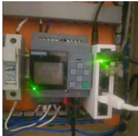
Imagen 3 Comunicacion Ethernet activa
