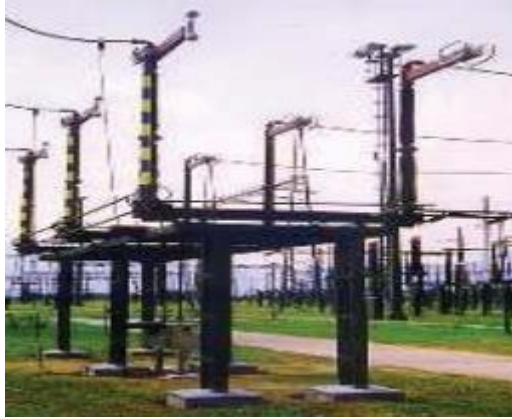
Ilustración 1.11. Seccionador de apertura central.
