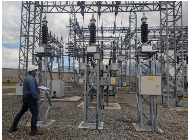
Ilustración 2.17. Levantamiento subestación Alpachaca.
