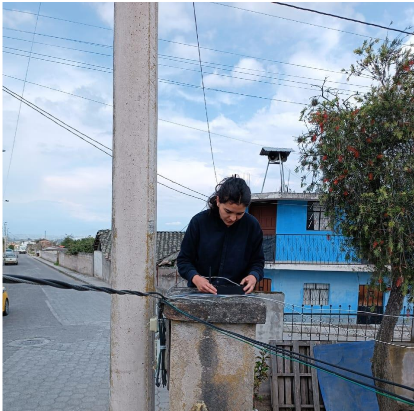
Figura 4. Instalación del nodo servidor en la Junta Administradora de Aguas
