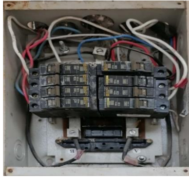
Figura 2. 7: Tablero de distribución 1
