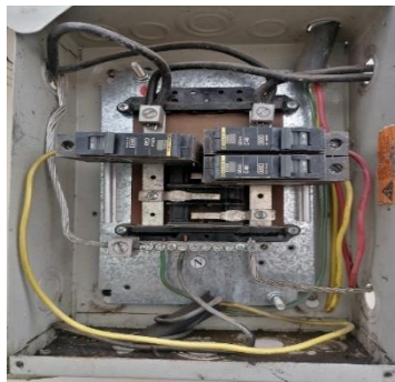
Figura 2. 8: Tablero de distribución 2
