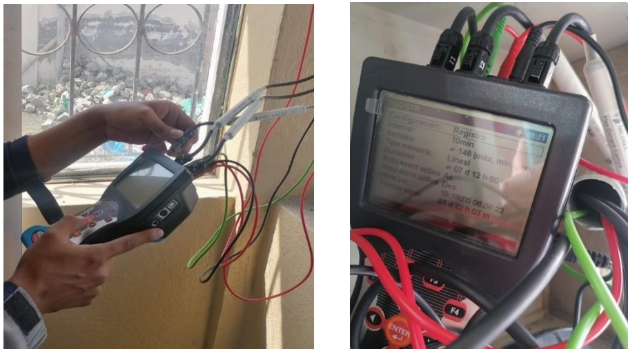
Figura 2. 11: Instalación del analizador
