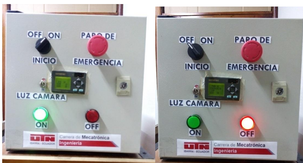
Figura 2.24 Gabinete de control
