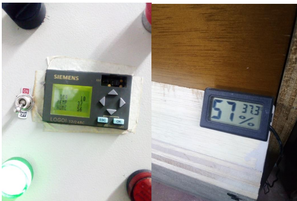
Figura 3.12 Comparación de valores del PLC y medidor digital
