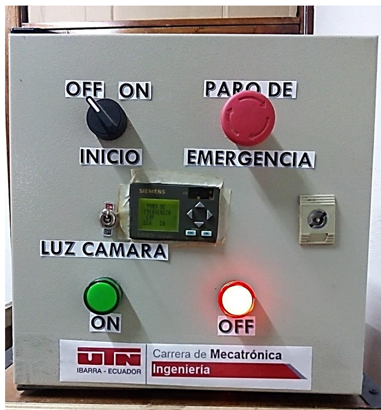
Figura 4.3 Vista exterior del tablero de control
