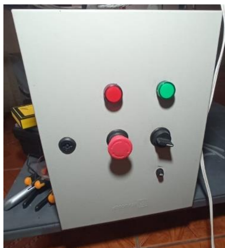
Figura 53 Parte externa del tablero de control Fuente: Propia Autoría
