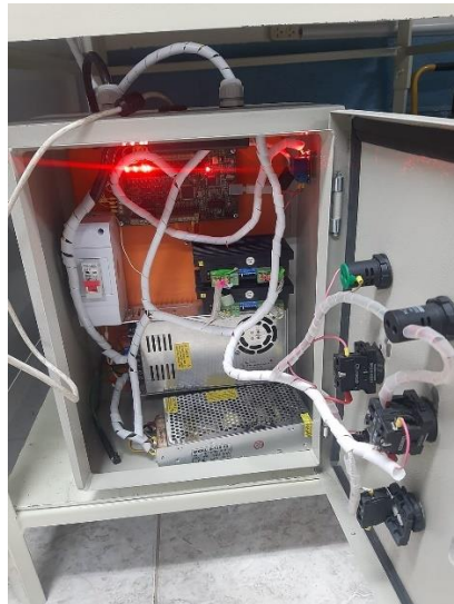
Figura 52 Tablero de control y todas sus partes. Fuente: Propia Autoría
