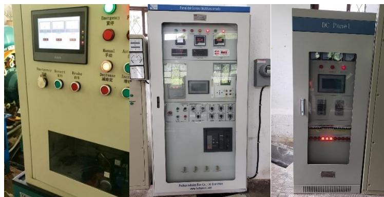
Fig. 19 Tableros de control: (a) regulador de velocidad, (b) distribución, (c) protecciones
