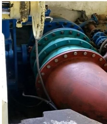
Fig. 16 Tubería de presión
