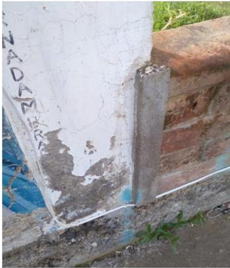
Figura 13.- Daños en el mural
