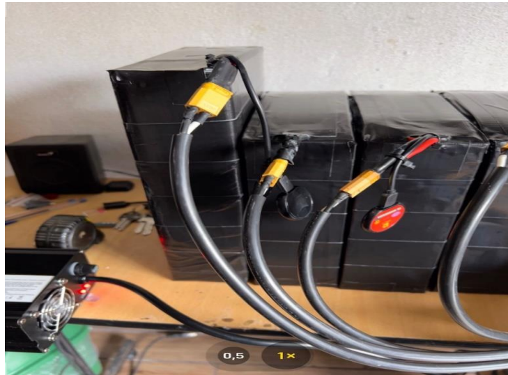
Figura 28 Proceso de carga de baterías de litio
