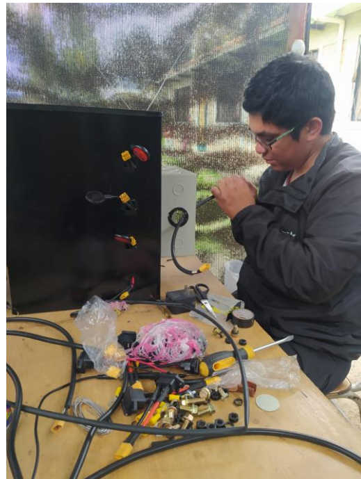
Anexo B Adecuación de paquetes de baterías de litio en caja metálica
